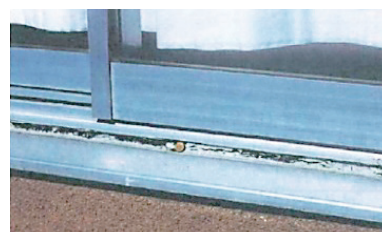
外壁・建具の周囲の劣化
